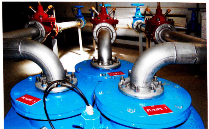
Grundwasserpumpwerk Bauzeit 1968 bis 1970
