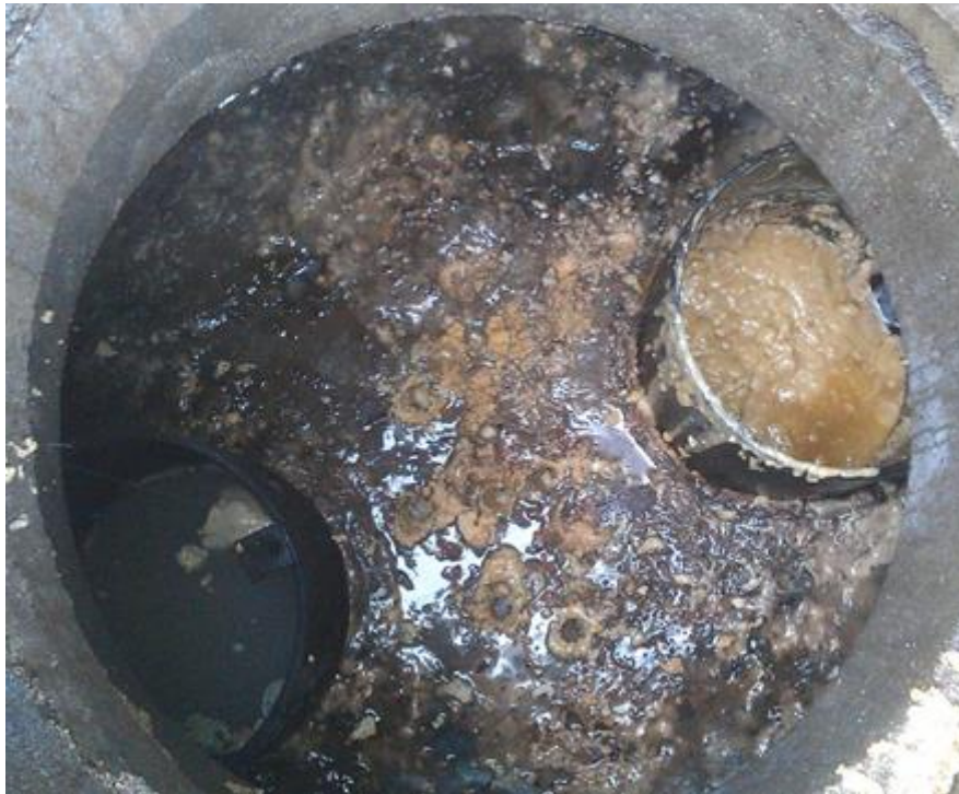
Abbildung 14: Rechtes Rohr: Zulauf mit dem frischen Fett, Linkes Rohr: Ablauf mit dem vom Fett gereinigten Abwasser; Hauptkammer des Fettabscheiders mit bräunlich, rötlich gefärbtem Fett.
